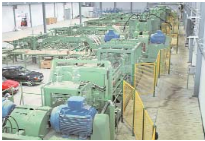
Profilier-Spaner-Kreissägeanlage während der Inbetriebnahme-phase
