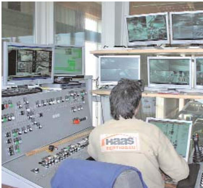
Zentrales Steuerpult: Bediener überwacht die Anlage
